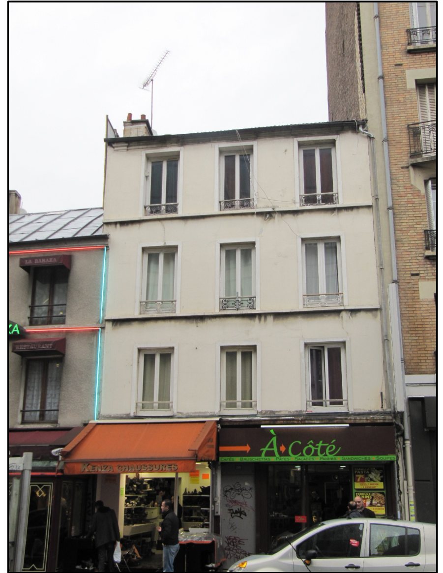
Immeubles très dégradés
