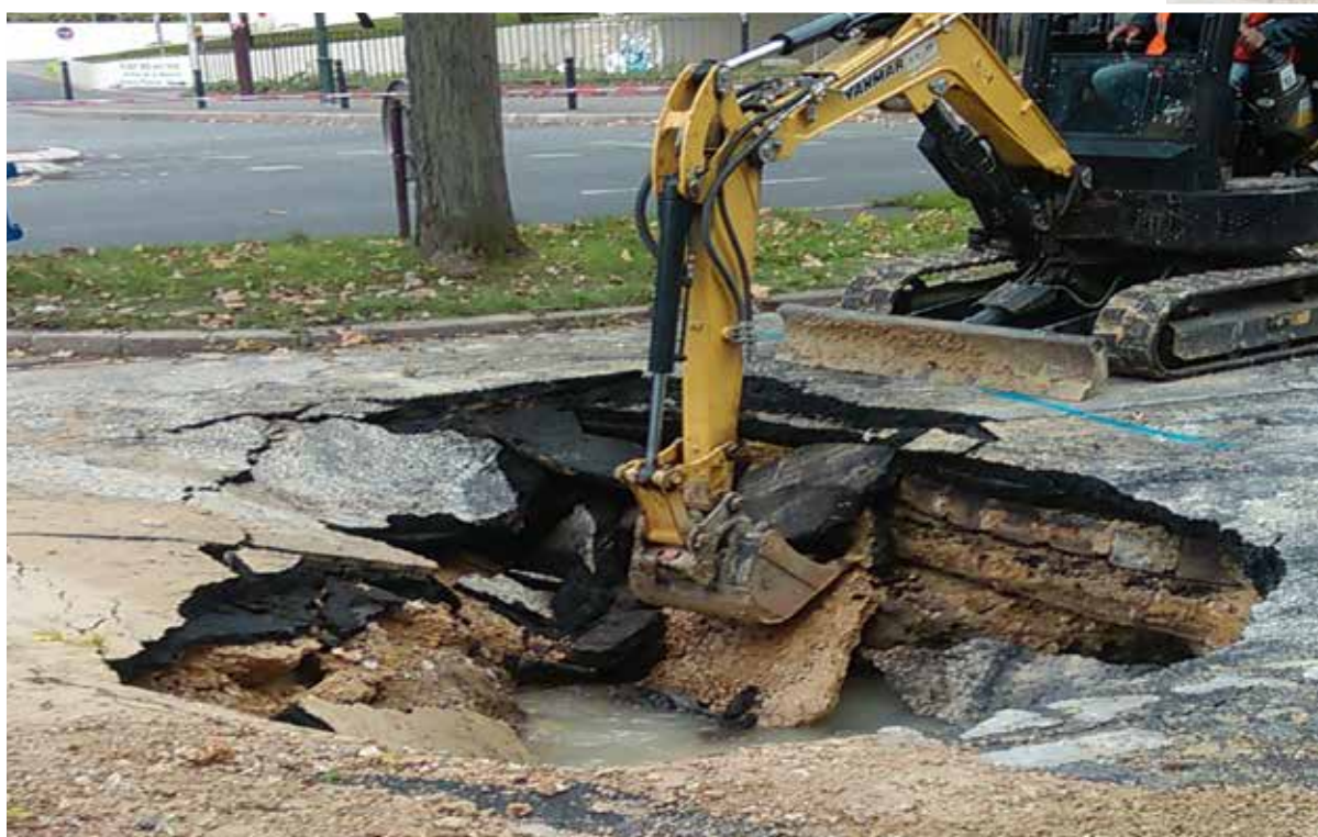
Effondrement de chaussée.
