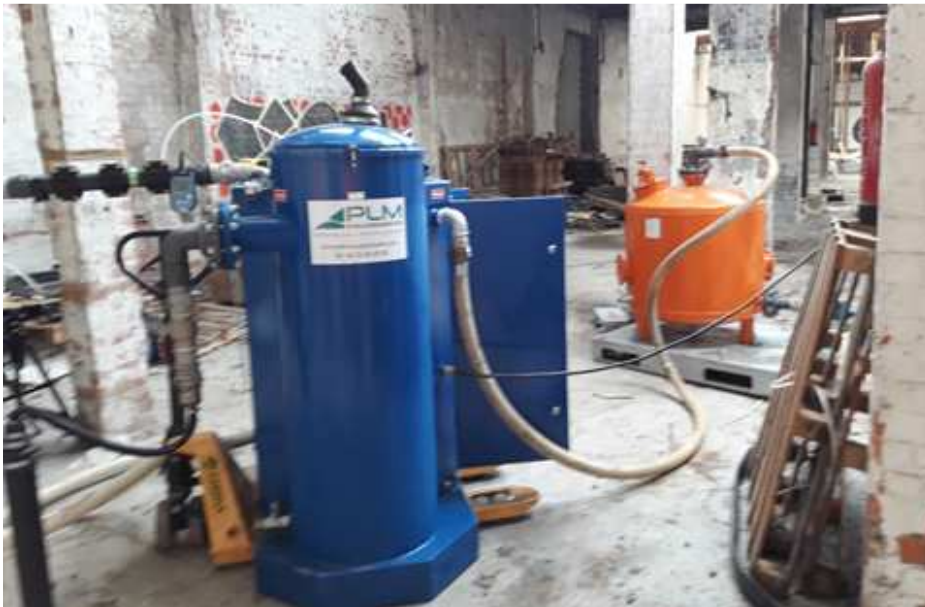
Figure 10 : Skid d'extraction multiphases
