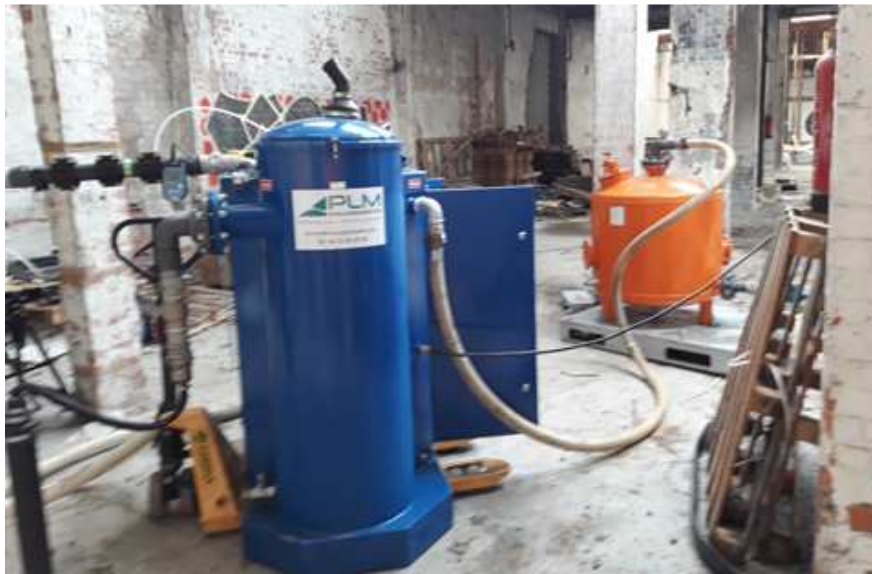
Figure 17 : Skid d'extraction multiphase
