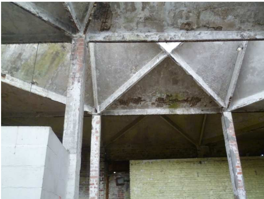
Dégradation partie basse de la coque béton
