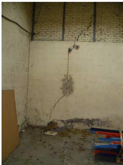
Fissure avec l'atelier C2
