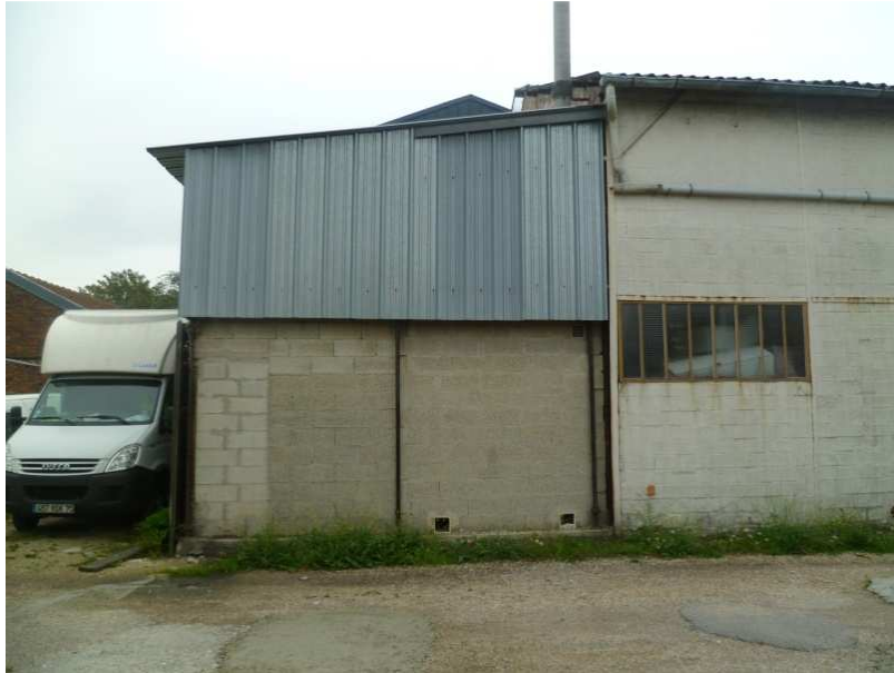
Arrière chaufferie (bâtiment F2)
