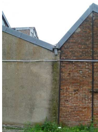
Descente de pluviale manquante en about de chéneau en pignon Est
