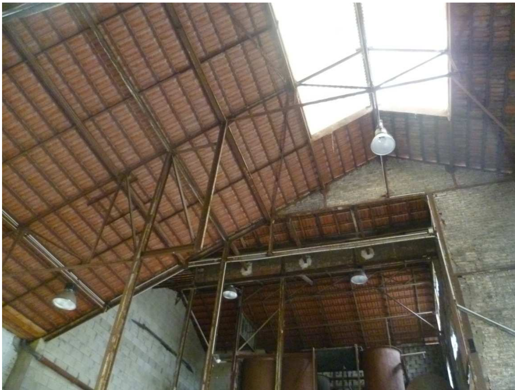
Charpente non continue au niveau des entrains
