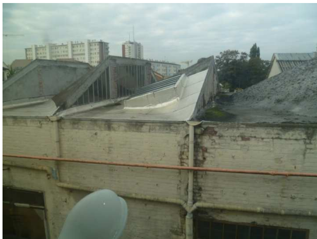
Coque béton présence d'une étanchéité rapportée de type auto protégée aluminium
