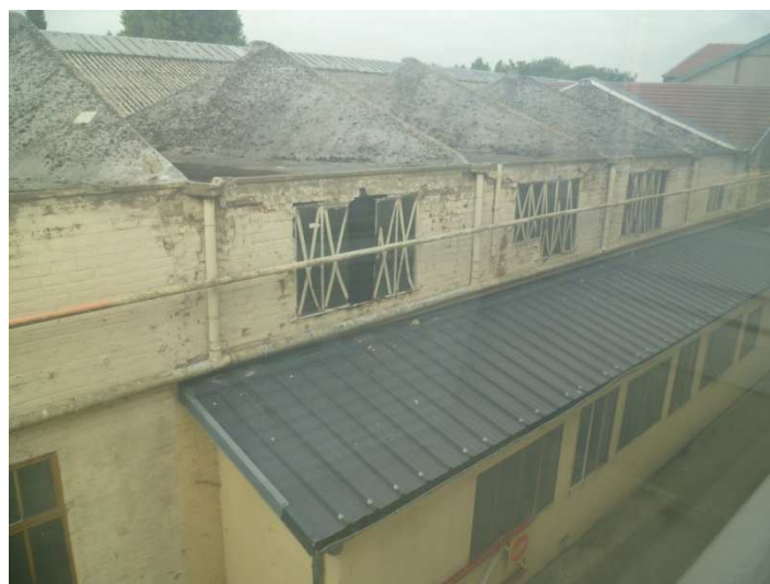
Coques béton partie centrale bâtiment E vue sur auvent latéral en bac acier Châssis latéraux obsolètes
