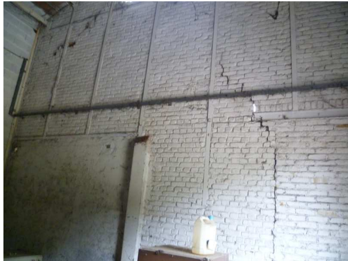
Fissure à 45° depuis l'atelier D
