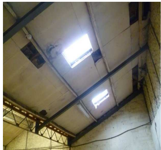
Décollement sous face plafond
