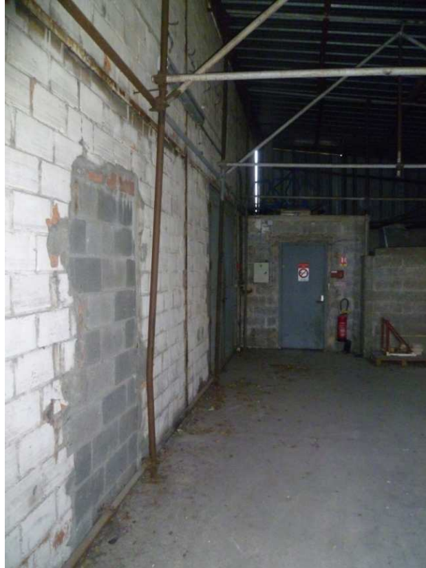
Le 1 er poteau métallique est en train de flamber
