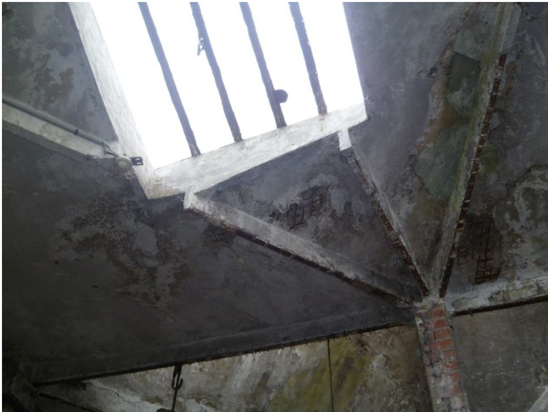
La réalisation ultérieure du lanterneau a sectionné les poutres béton
