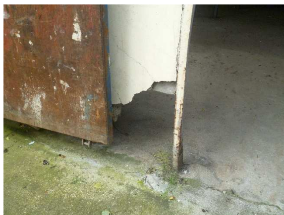
Conséquence d'un choc sur façade et montant métallique
