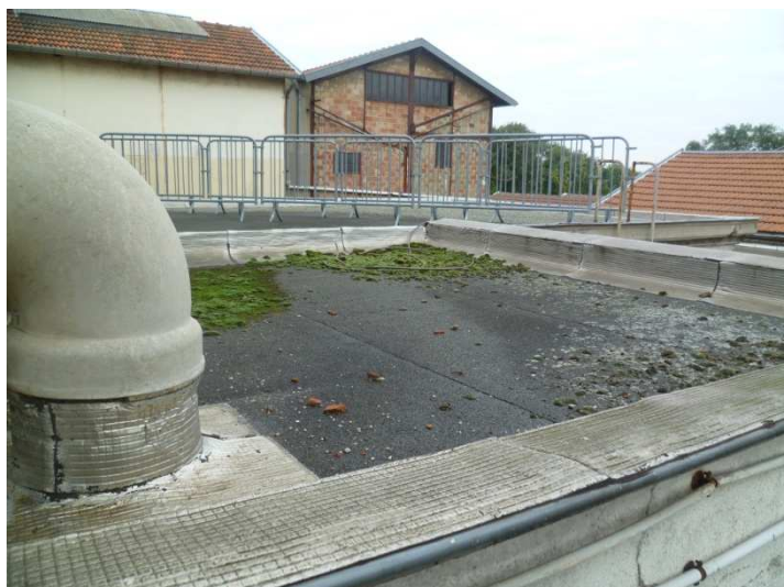
Terrasse plancher haut 1er étage présence de mousses en surface
