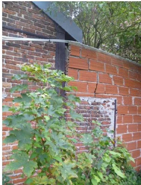
Façade du « patio extérieur » complètement déstabilisée
