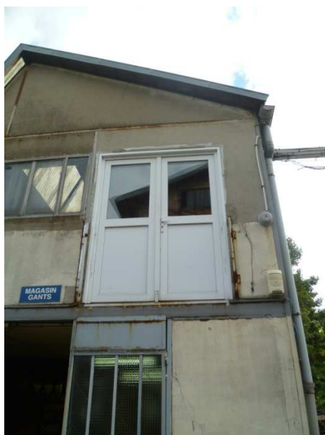
Porte fenêtre 1er étage sur corridor central sans barre de protection
