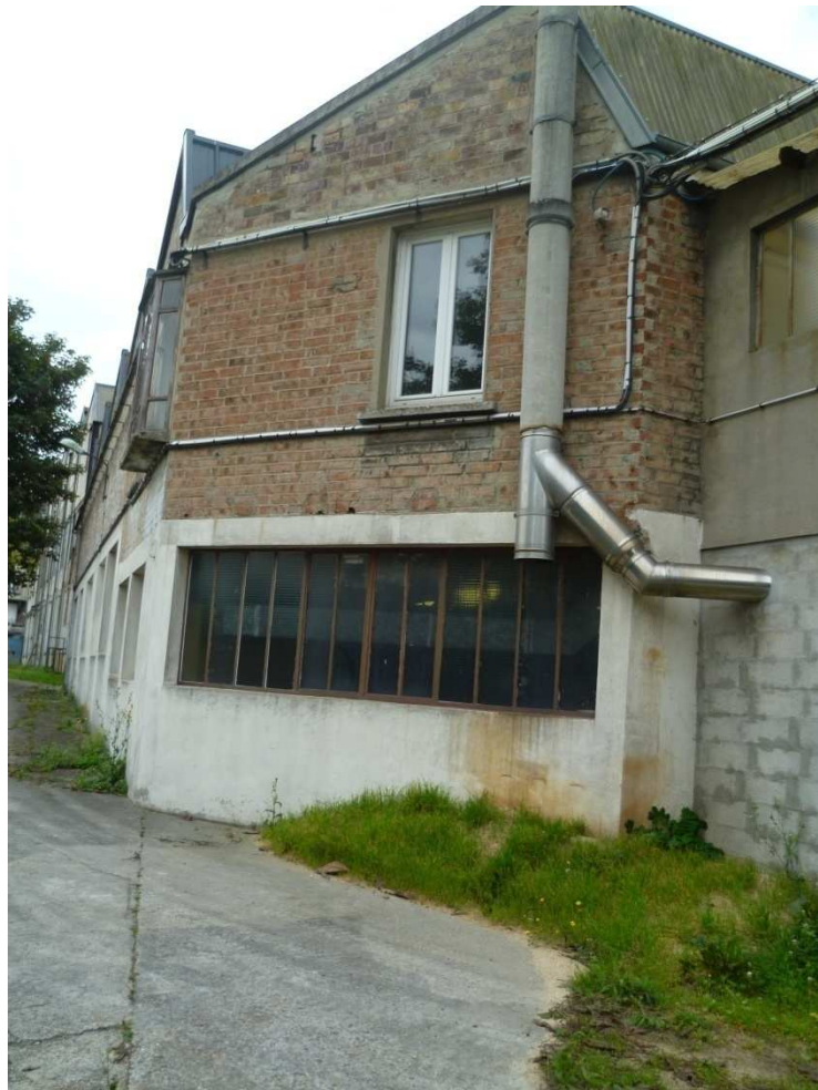
Sortie chaufferie bâtiment B
