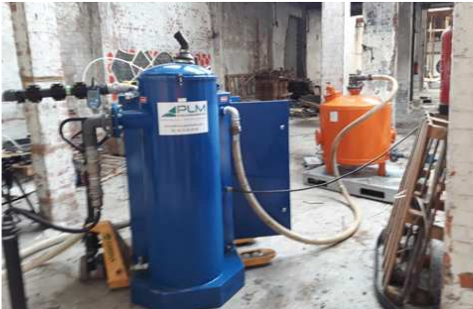
Figure 10 : Skid d'extraction multiphases
